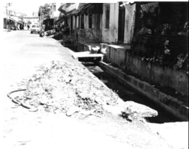
Le caniveau a été nettoyé mais les résidus ne sont jamais ramassés
